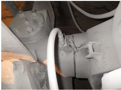
ダストシール破損、軸部傾きが発生
